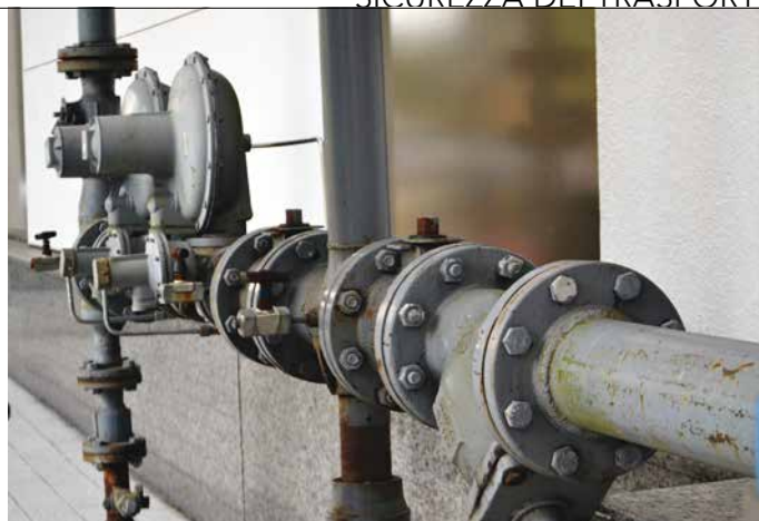
3. Particolare di una condotta idraulica (photo credit: F. Muhammad da Pixabay)
